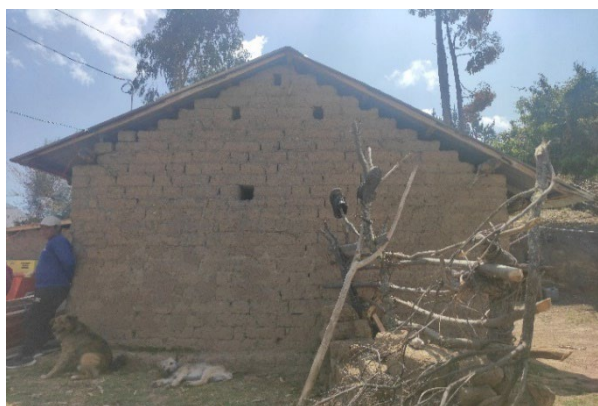
Figura 2: Vivienda típica de adobe con unión cubierta-cerramiento deficiente.
